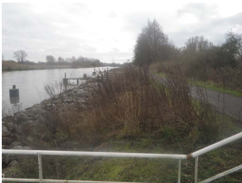
Vue sur le secteur concerné par l'allongement / réfection du poste d'attente amont
